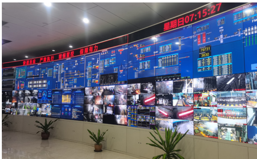
能源管理系统视频监控区域
